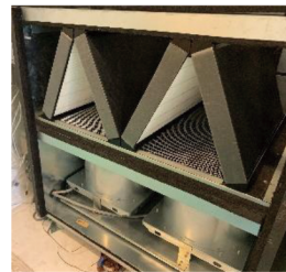
写真2 全館空調搭載の HEPA フィルタ
